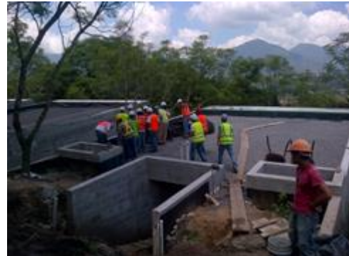
Estudiantes en la parte alta de uno de los módulos de habitaciones.
