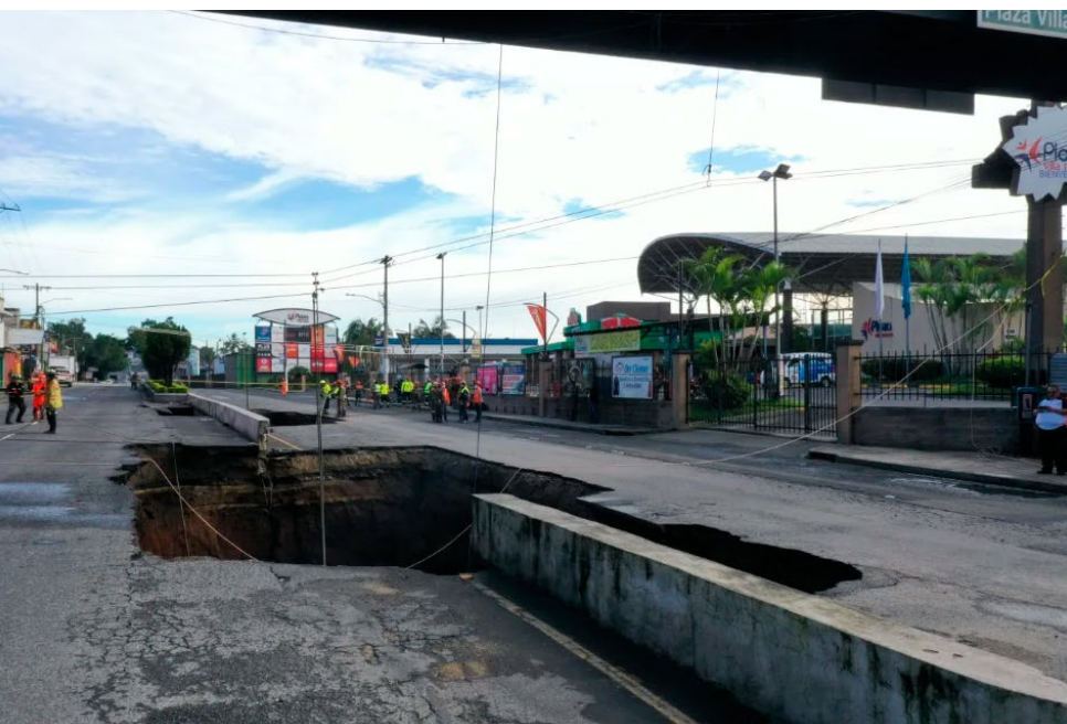
Foto: Socavón de Villa Nueva
