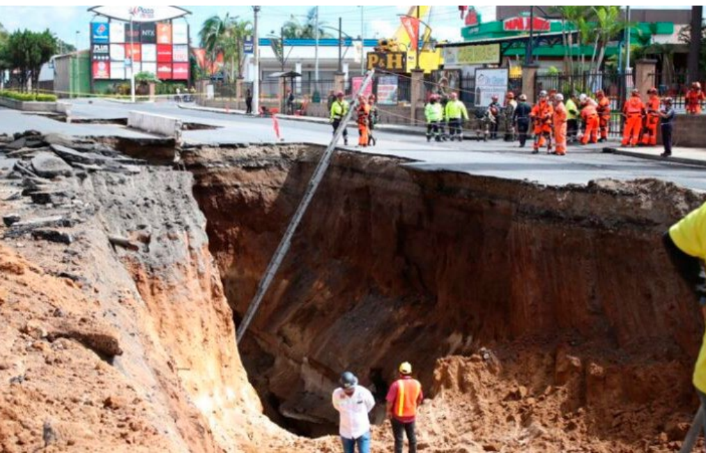
Foto: Socavamiento en Villa Nueva
