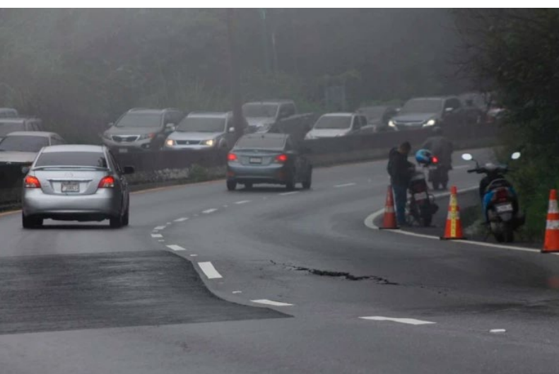
Foto: Hundimiento en carretera a El Salvador
