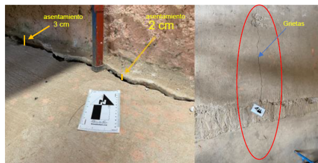
Figura 4. Grietas dentro de una de las clases de la escuela Chajcoal, San Juan Chamelco.
