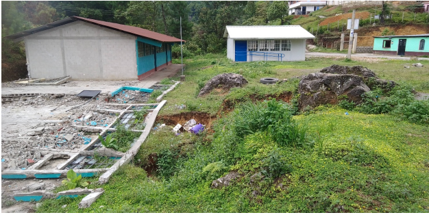
Figura 2. Escuela Chicujal San Juan Chamelco, afectado por colapso por karst. Foto tomada por Pablo Yoj, 2023.
