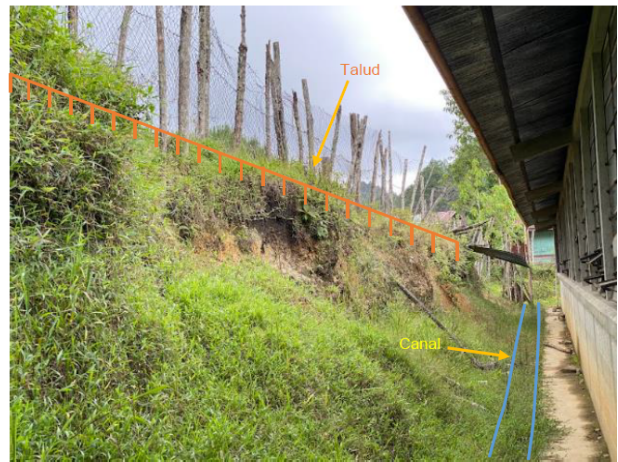
Figura 3. Deslizamiento ubicado en la parte trasera de la escuela Chioya, San Juan Chamelco.
