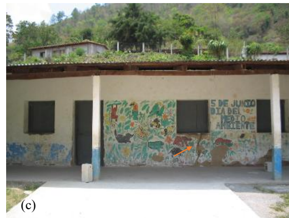
Figura 8. Características y disposición de patrones de grietas en paredes de los módulos A y B. 8a) Vista al noreste de pared con grietas verticales y desnivel con caída hacia el sureste. 8b) Grieta a 70^\circ con abertura de 2cm. 8c) Panorámica módulo "A" de los años 90s, donde la infraestructura muestra grieta. (Tomado de Grifos 7.0, Mineduc).
